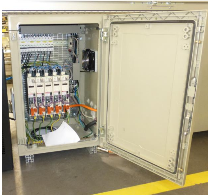
Vue de l'armoire de commande
