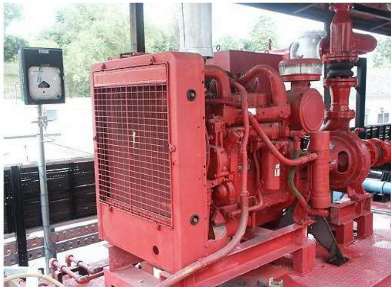
Pompe de remplissage de camion de pompier
